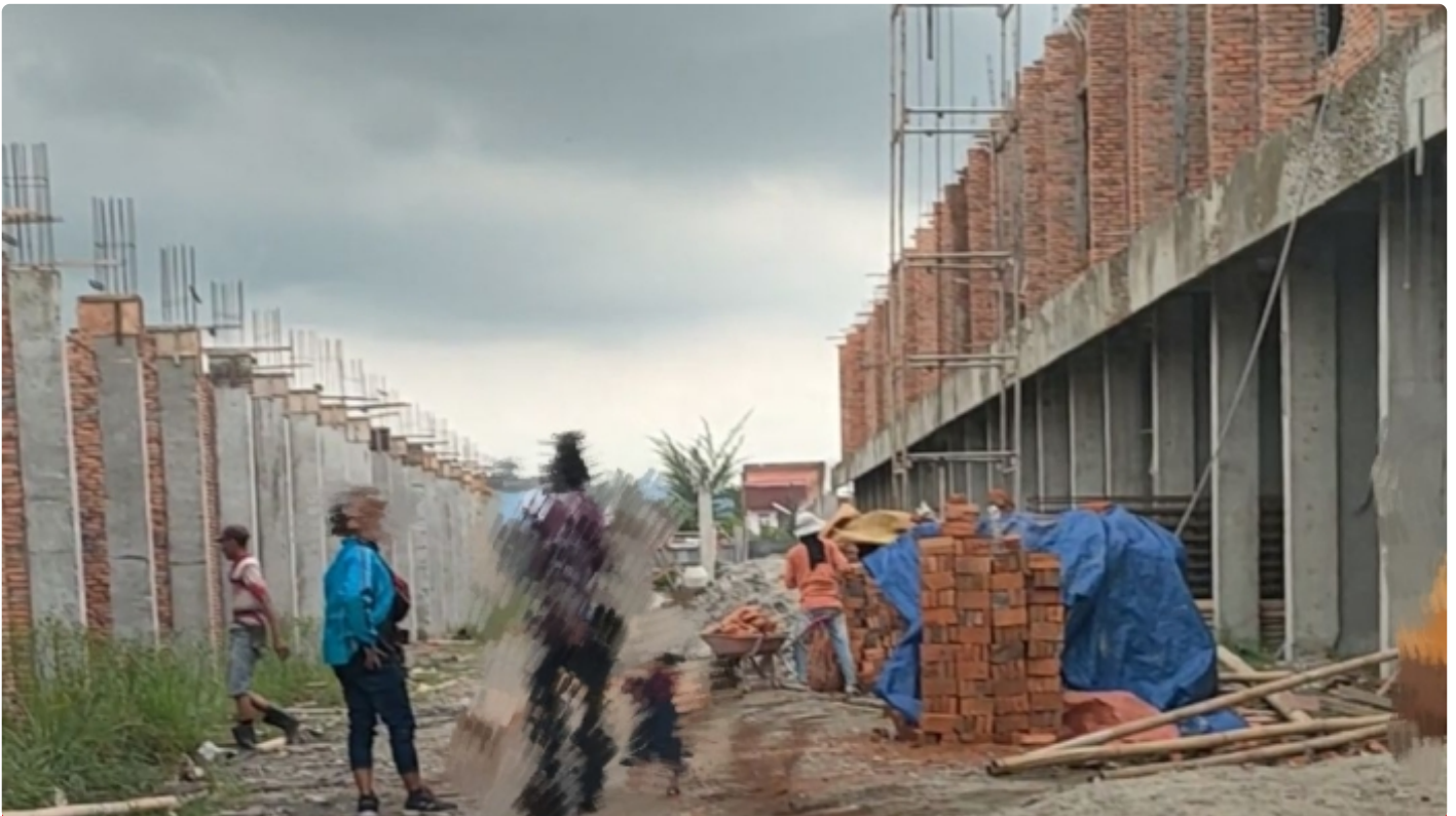
Bangunan di Jalan Air Bersih Ujung yang diduga menyalahi SIMB
